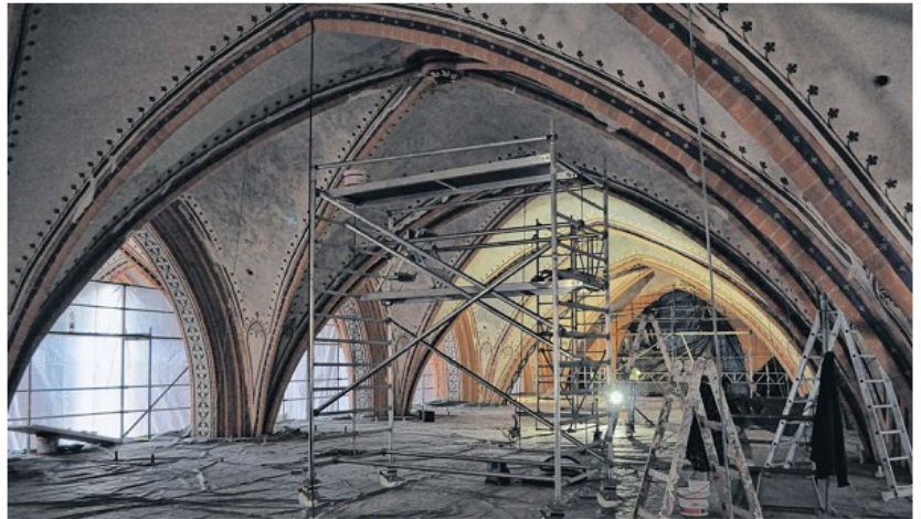
Das Gerüst reicht bis dicht unter das Gewölbe der Sankt Bartholomaei Kirche. Das Gewölbe wurde inzwischen gereinigt und Risse wurden gepresst. Keiner der Schlusssteine gleicht dem anderen.
